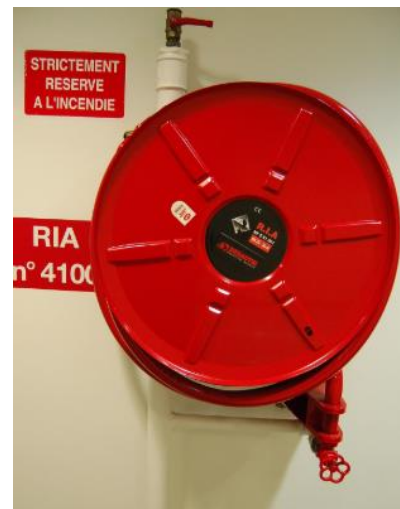
La Figure 07 : Poste de RIA
