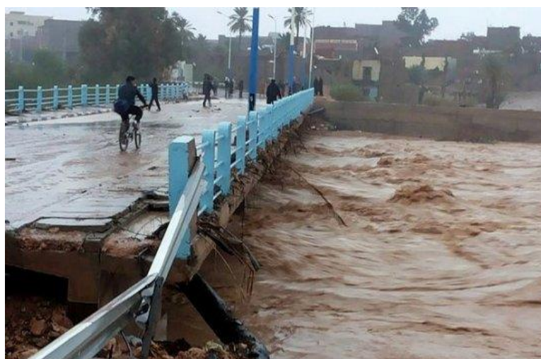
Fig. 100. Les inondations du 08 septembre 2024 à Béchar
