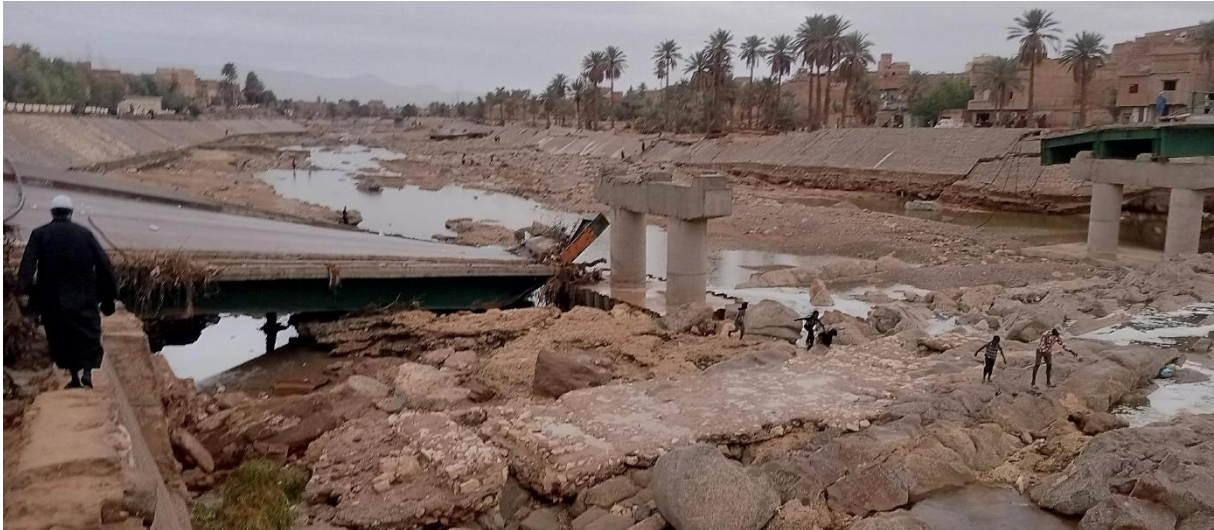
Fig. 104. Les deux ponts principaux de la ville effondrés
